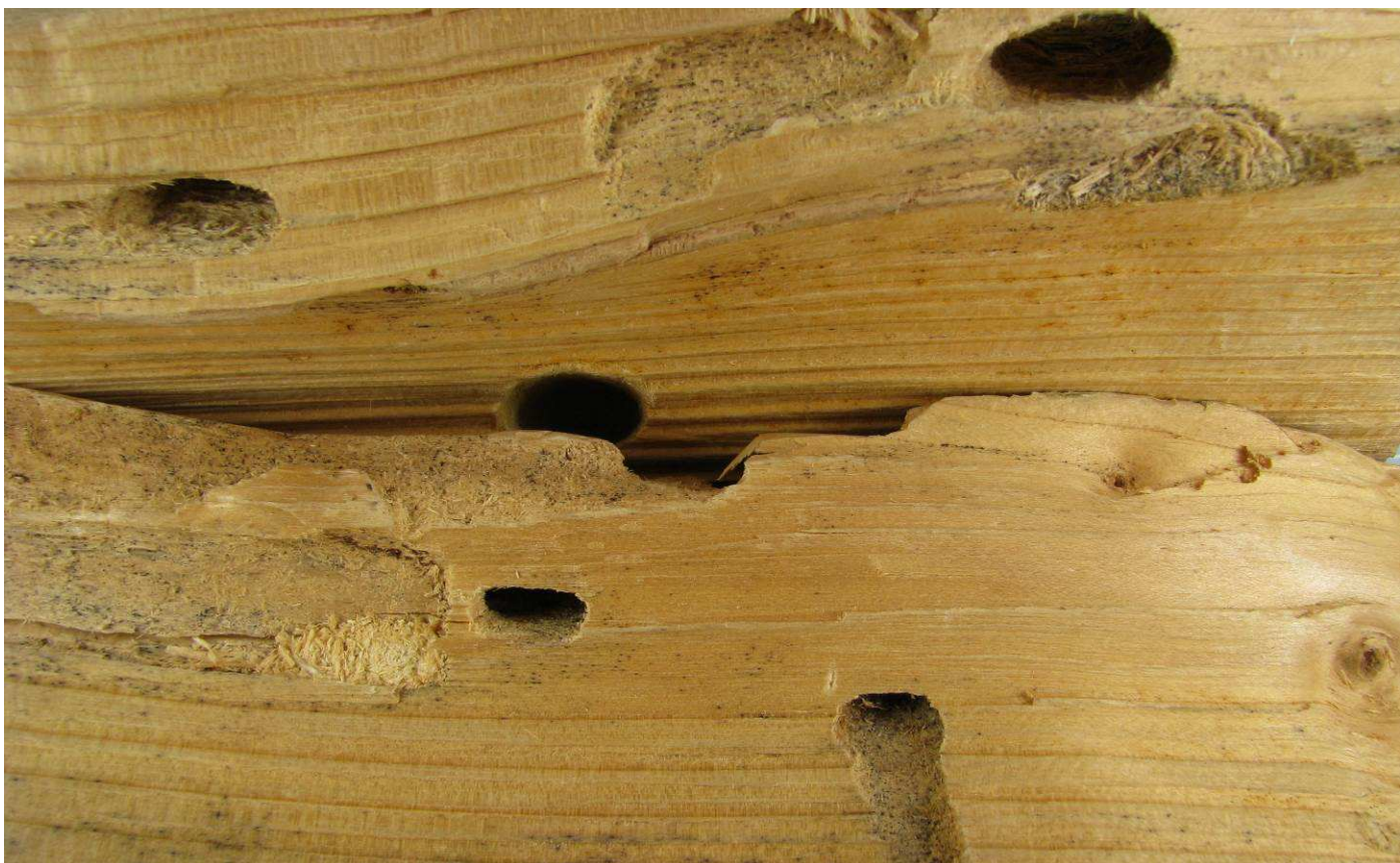
Spłaszczone w przekroju korytarze larw żerdzianek w drewnie świerkowym, widoczne wypełniające je ciasno zbite trocinki.
